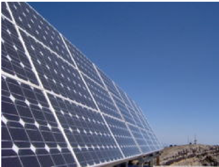
Figura 2.20: Exemplo de painel solar. Adaptado da referência 78.
