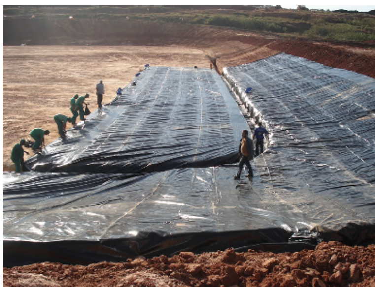
FIGURA 15: Aterro Sanitário: impermeabilização do solo Fonte: Ponta Grossa Ambiental, período próximo a 2005
