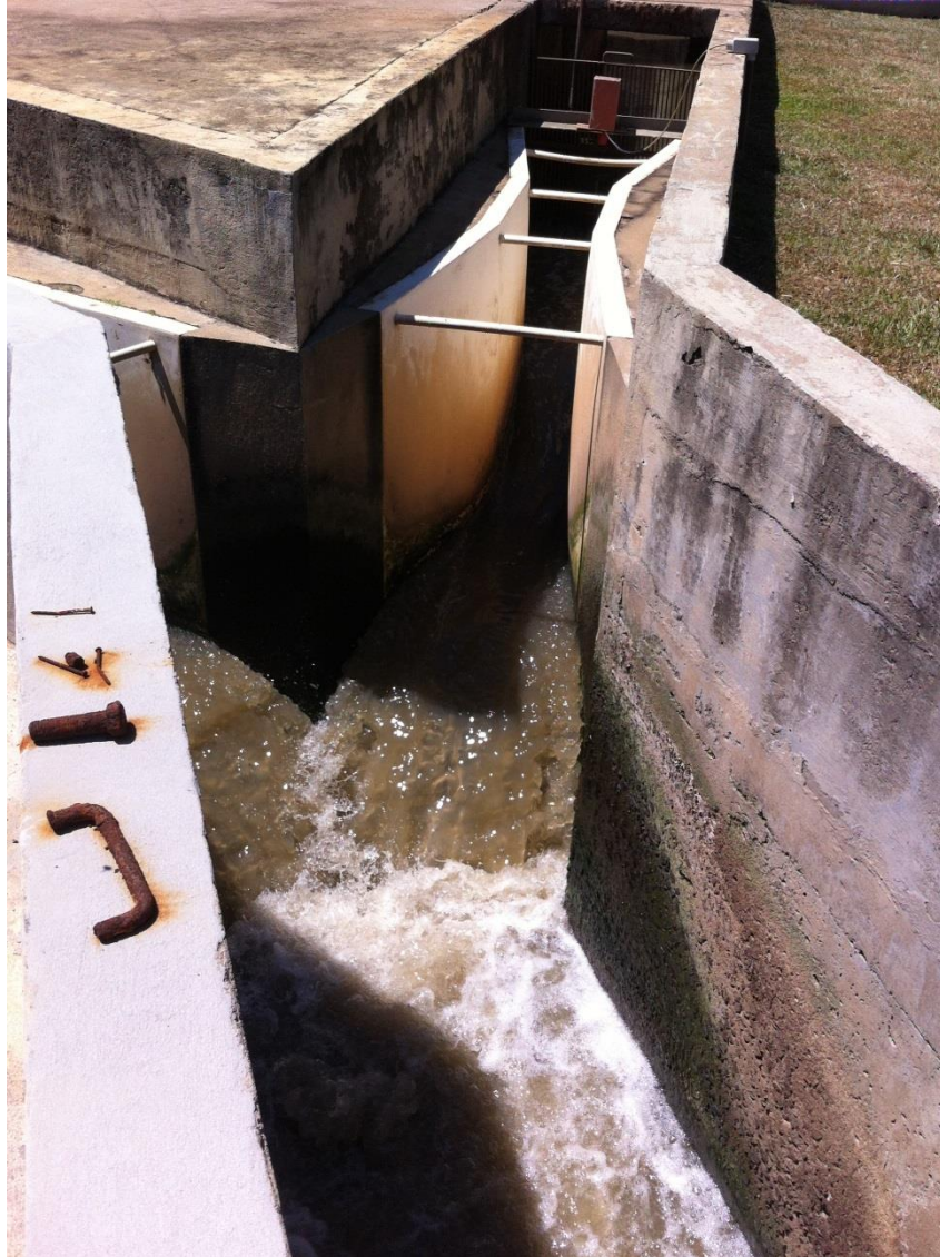
Figura 12 – Foto do ponto de coleta após gradeamento do esgoto.
