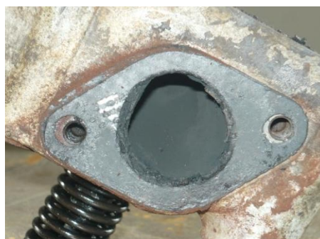
15b. Ducto de escape do E-2
