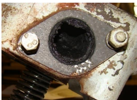
15a. Ducto de escape do E-1
