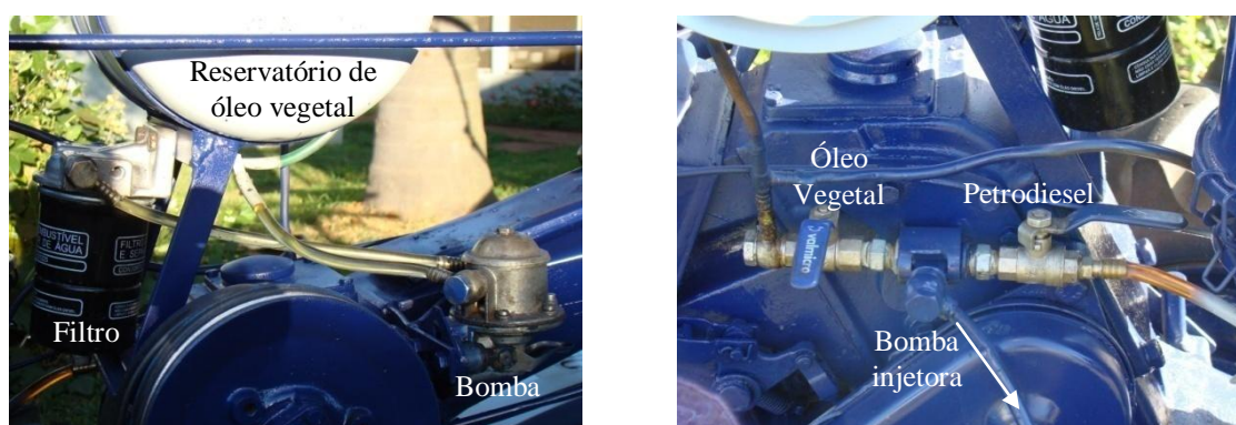
FIGURA 6. Sistema para bombeamento, filtragem e conversão para óleo vegetal
