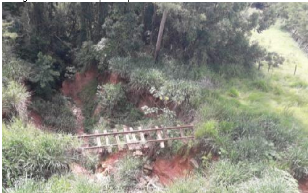
Fotografia 12: Trilhos suspensos próximo ao viaduto da RFFSA em W. Braz, 2018
