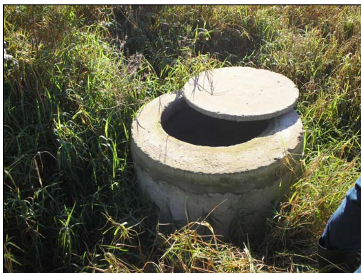
FIGURA 32: Poço de monitoramento presente no aterro controlado. Fonte: Autoria própria, 2007.
