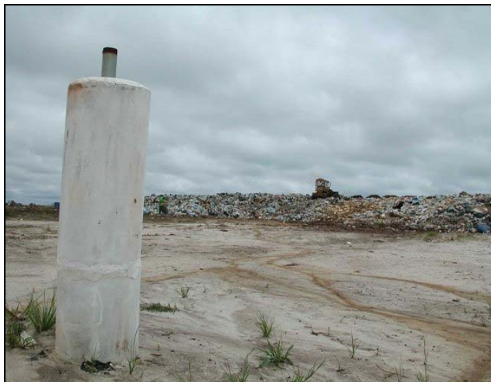
FIGURA 23: Foto Aterro Controlado do Botuquara: Sistema de drenagem de emissões gasosas. Fonte: Ponta Grossa Ambiental, período próximo a 2001.
