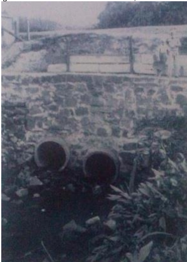
Figura 30: Bueiro rua Catão Monclaro, Centro.
