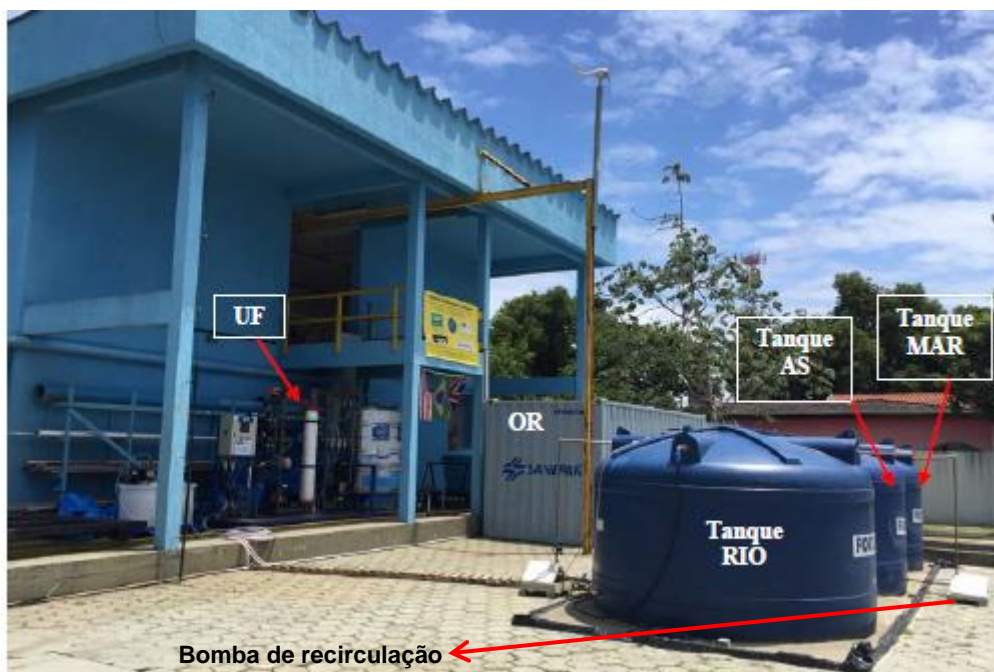
Figura 4 – Instalação piloto de dessalinização
