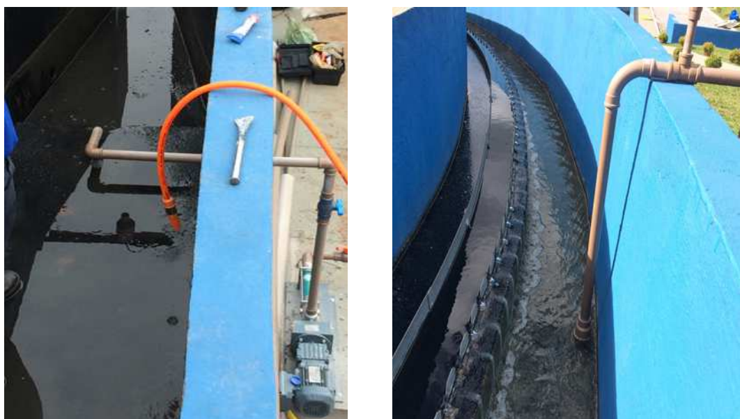
Figura 14 - Ponto de alimentação do esgoto bruto após sistema preliminar e ponto de alimentação de efluente do RALF 1.
