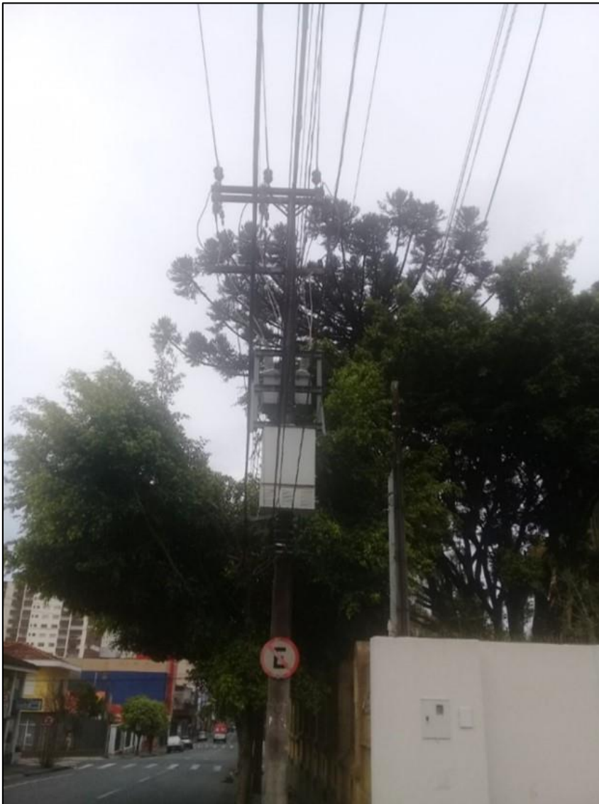
Figura 02 - Exemplo de conflito com a fiação.
