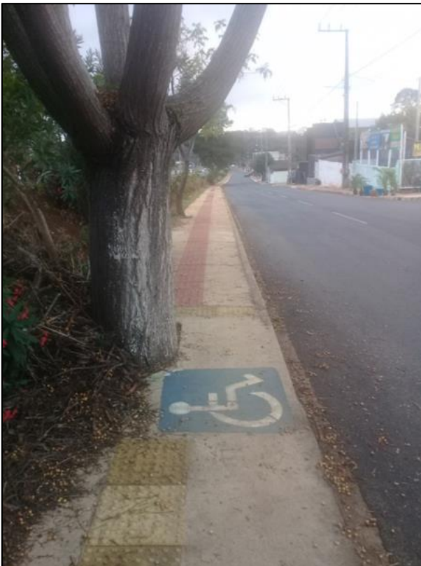
Figura 04 - Exemplo de conflito com a acessibilidade.
