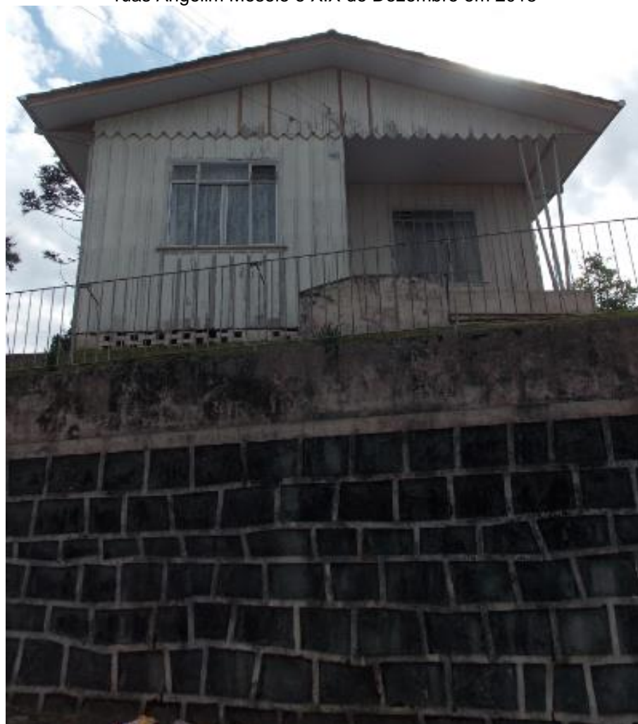
Figura 115 – Fotografia III de uma residência em madeira localizada na Rua XV de Julho entre as ruas Angelim Mosele e XIX de Dezembro em 2018
