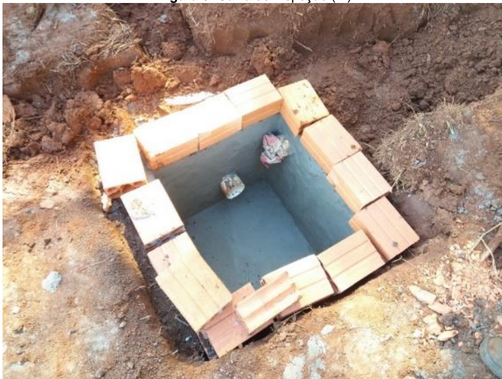
Figura 8: Caixa de Inspeção (Pi)
