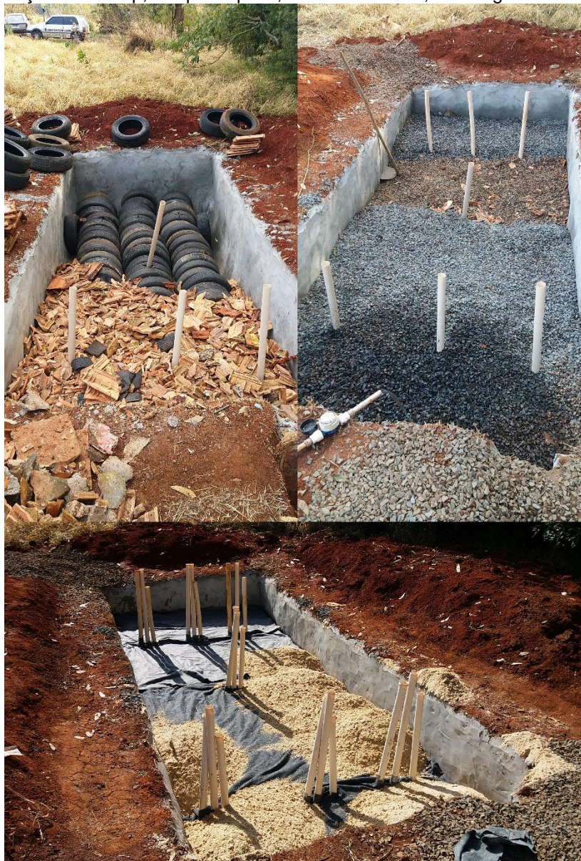
Figura 4: Implantação do TEvap, tanque séptico, camada de brita, manta geotêxtil e camada de areia
