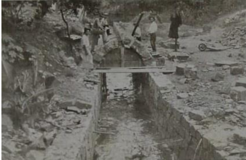
Figura 20: O serviço de canalização do arroio Pilão de Pedra, dentro do quadro urbano (legenda original)
