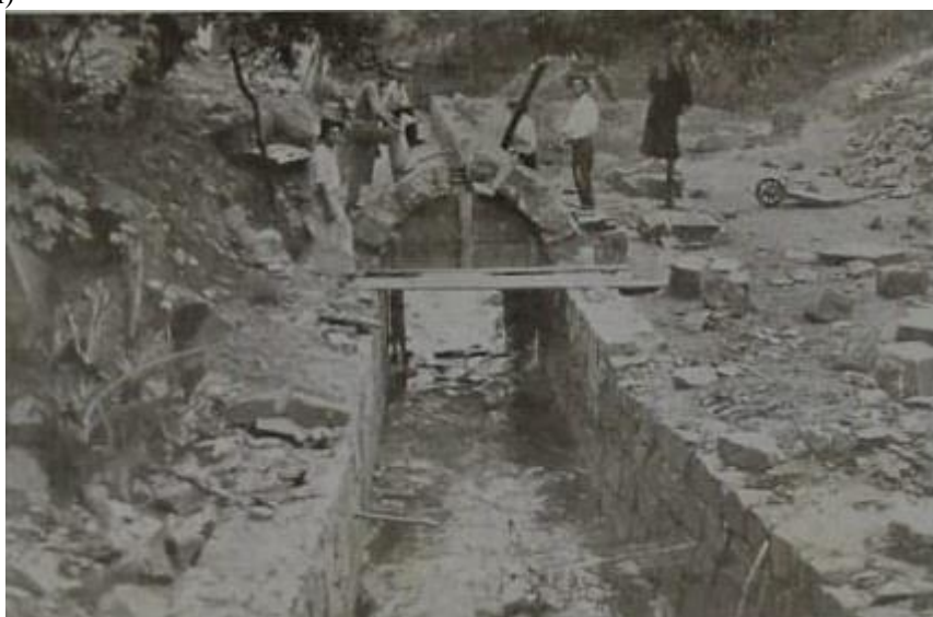
Figura 18: O serviço de canalização do arroio Pilão de Pedra, dentro do quadro urbano (legenda original)
