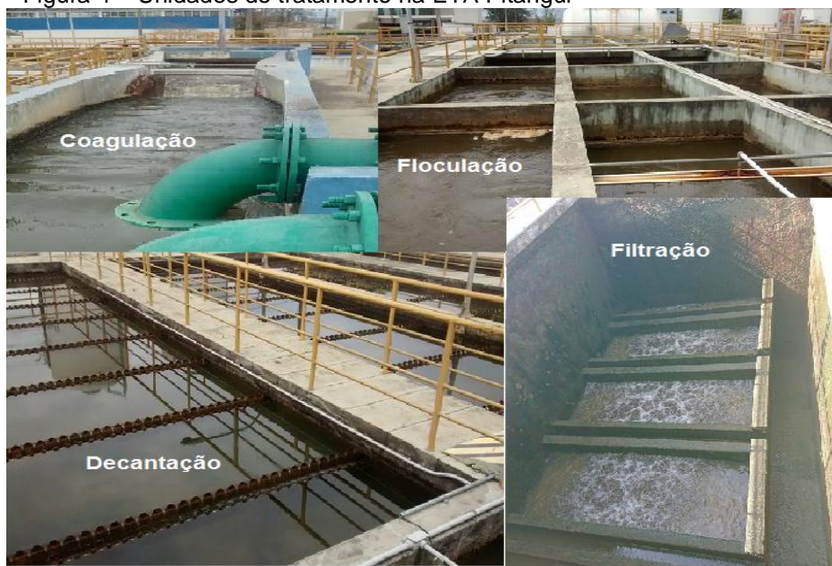
Figura 4 – Unidades de tratamento na ETA Pitangui
