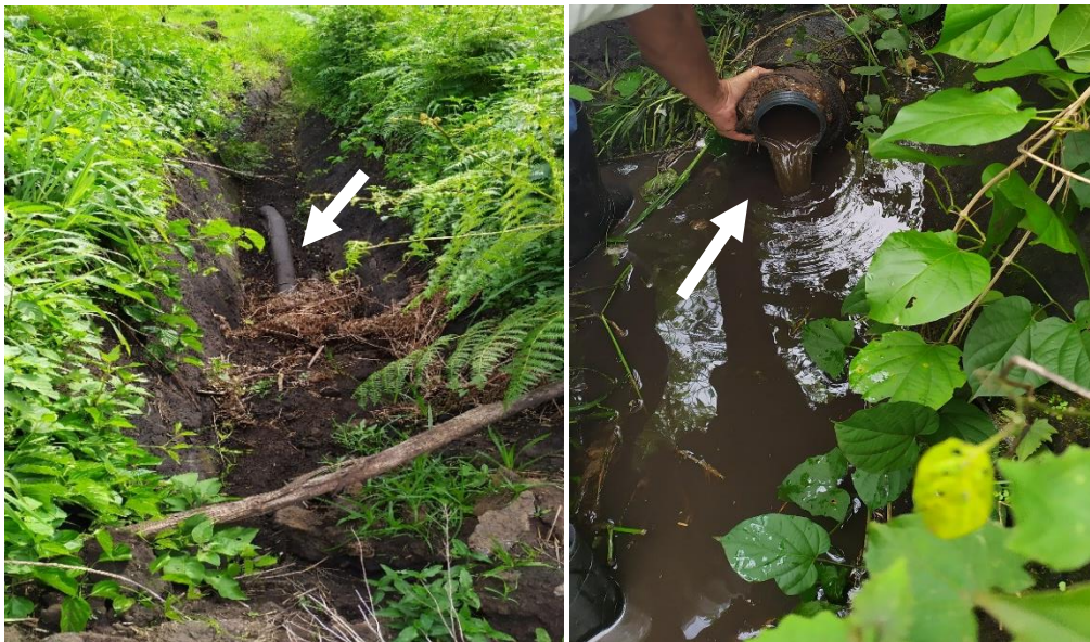
Figura 4: Fotos do tubo coletor de água de drenagem.
