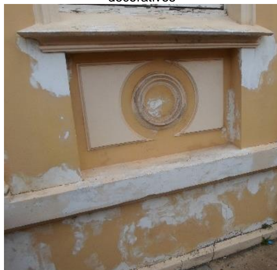
Figura 58: Fissuramento de elementos decorativos
