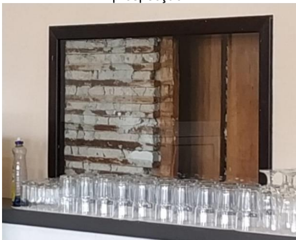
Figura 47: Parede de Estuque, janela de prospecção.
