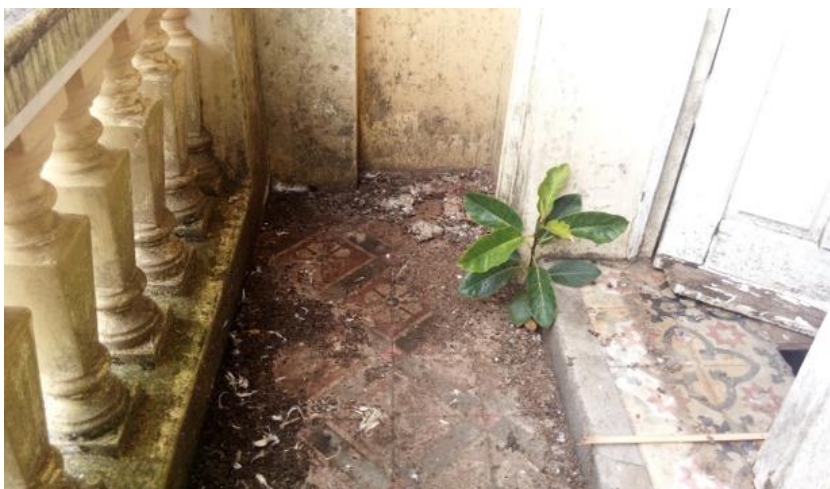
Figura 60: Infiltração piso da sacada
