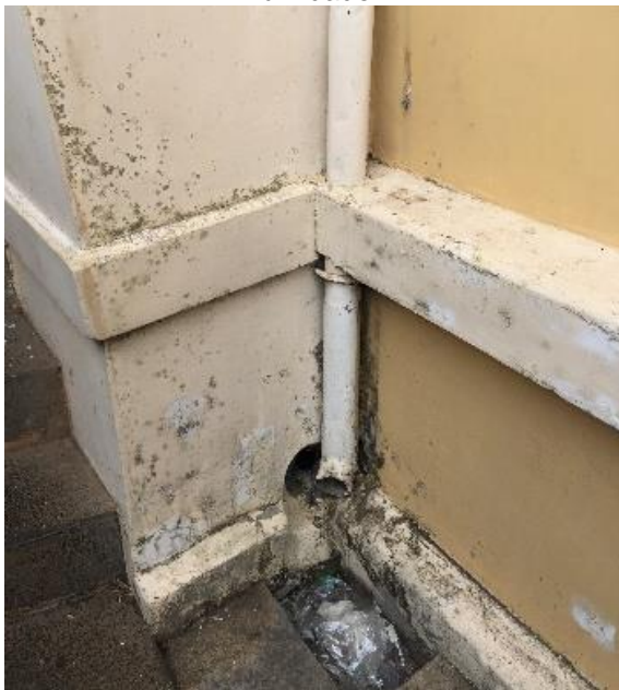
Figura 57: Sinal de escoamento e manchas de umidade
