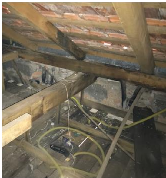
Figura 59: Infiltração na estrutura de madeira telhado
