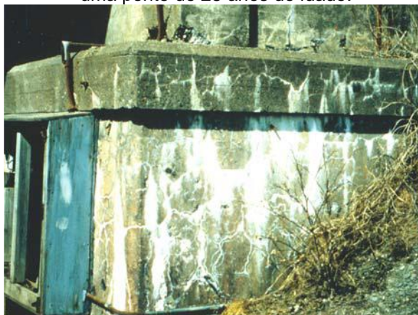
Figura 2 – Eflorescência e exsudação de gel álcali-silica na superfície do concreto de fundação de uma ponte de 25 anos de idade.
