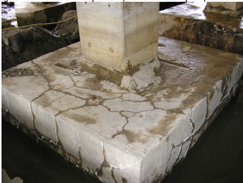
Figura 14 - Bloco de fundação com padrão de fissuração típico de RAA.
