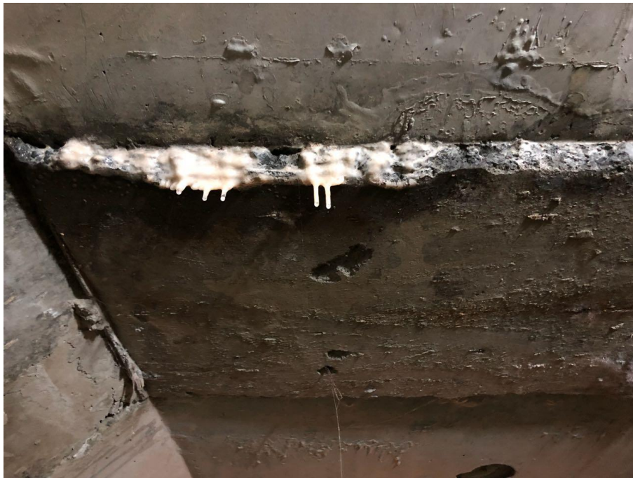
Figura 2.5 - Exsudação de gel em estrutura afetada por RAA
