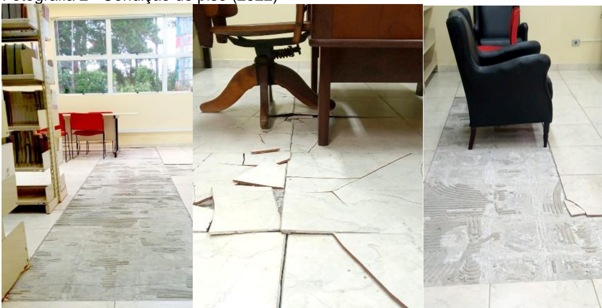
Fotografia 2– Condição do piso (2022)
